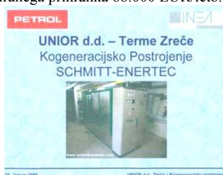
Slika 23-Kogeneracijska naprava Terme Zreče
