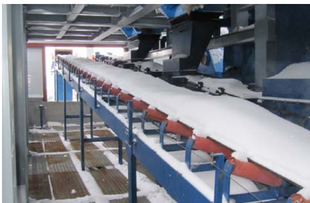
Slika 3: Težavni pogoji vgradnje
