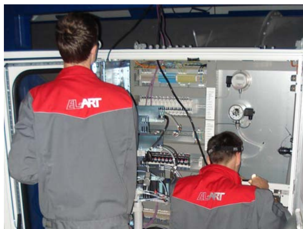
Slika 5: Priklučitev/priprava električne omare
