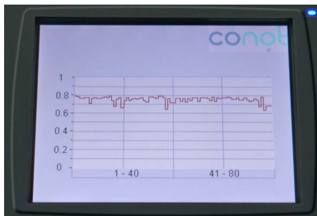
Slika 3: Prikaz napetosti PEM gorivnih celic večjega sklada na HMI terminalu.
