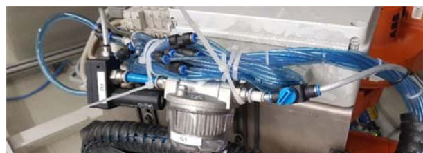
Slika 8: Cevke za tlak in vakuumski generator.
